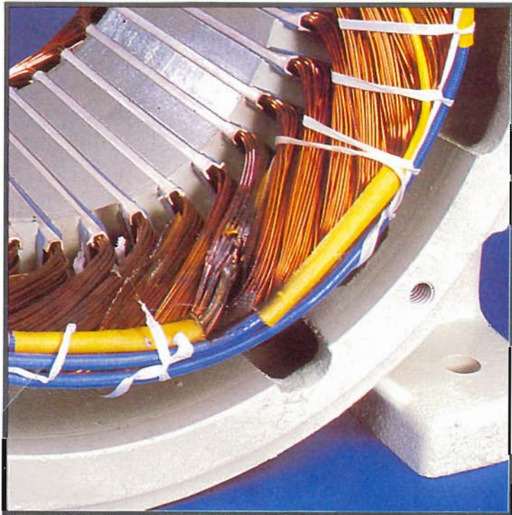
12 電壓凸波造成線損毀
