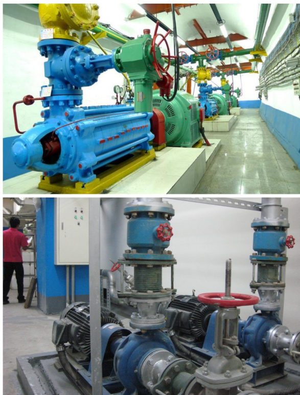
鑄鐵臥式泵實際現場安裝圖
