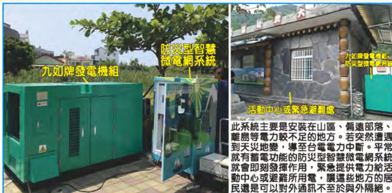
九如牌防雨防音型發電機組+防災型智慧微網系統
